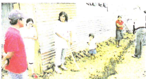
Mangels Abwasserkanälen graben Slumbewohner eine einfache Rinne zwischen die Behausungen. Stefan Bolln (rechts) unterstützt.
